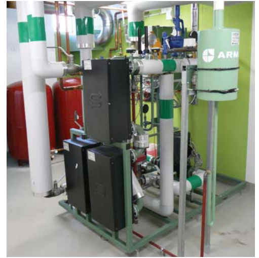
Einspeisestation der schwedischen Firma Armatec
