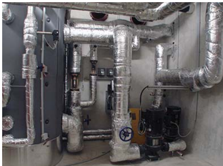
Einbindung der Solarthermieanlage in das Fernwärmenetz
