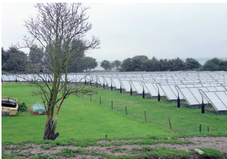
Figura 2 Impianto con collettori solari installati a terra (foto: Riccardo Battisti)
