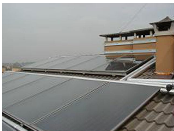
Figura 3-1 Impianto installato su tetto a falde
