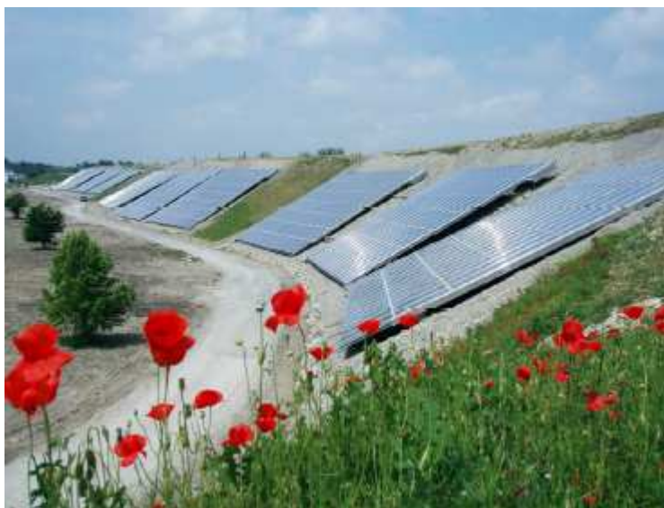
Figura 3-1 Impianto con collettori solari installati a terra (fonte: SDH Guidelines)
