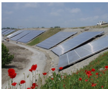
Illustration 2 : Sur une pente (Schüco), Crailsheim, Allemagne (par Stadtwerke Crailsheim GMBH). Noter la taille comparée à la voiture en haut et à l'homme en bas. [1], Fiche action 2.2
