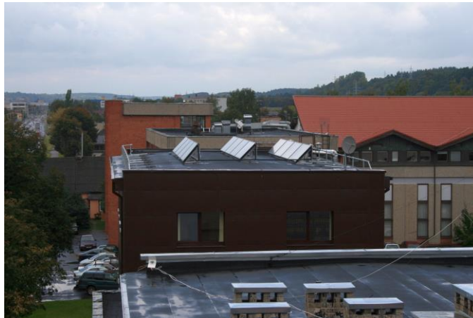
6 pav. Sumontuoti saulės kolektoriai ant AB „Kauno energija“ administracinio pastato stogo
