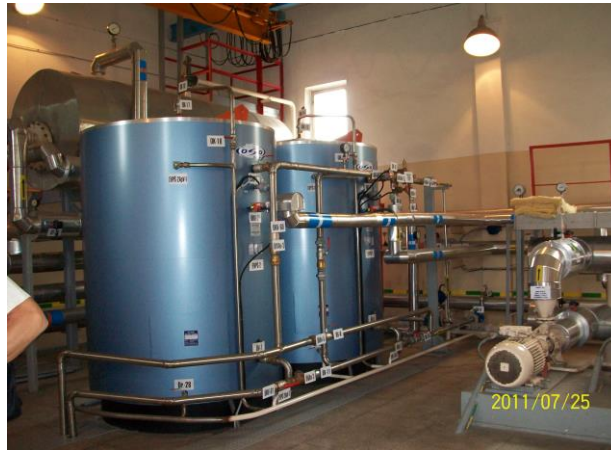
8 pav. Sumontuotos akumuliacinės talpos
