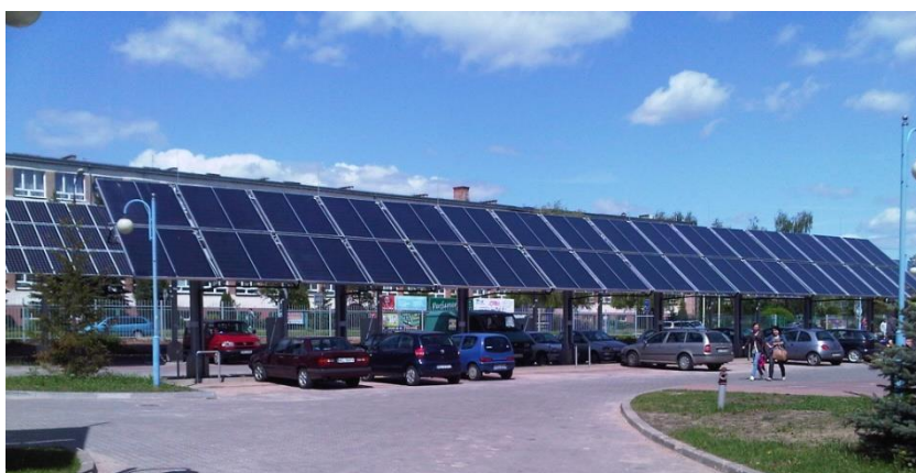
Basen w Elku, 174xES2V/5,23; powierzchnia brutto zainstalowanych kolektorów 910m 2 / czynna 820m 2 ; moc maksymalna: 673 kW Źródło: Ensol
