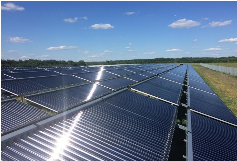
Abbildung 38: Freiflächen-Solarkollektoranlage in Senftenberg 107
