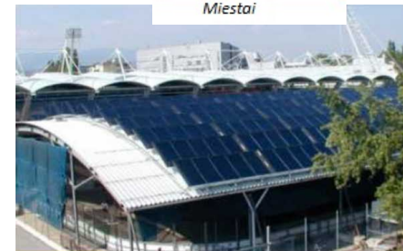
Plant In Stadion Liebenau, Graz (AT)
