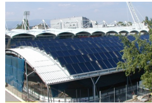
Plant in Stadion Liebenau, Graz (AT)
