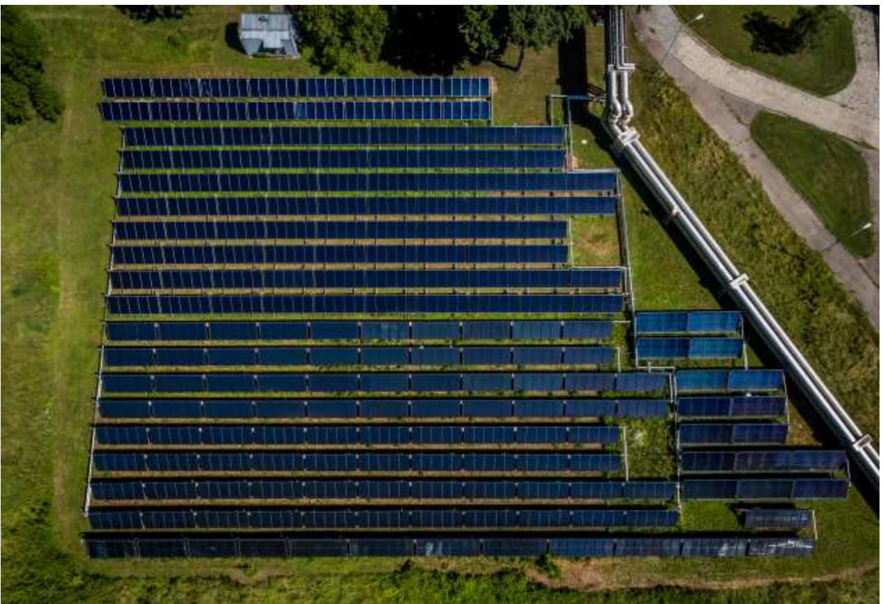
Abbildung 10: Größte Solaranlage Österreichs (Bildquelle: Picfly.at)
