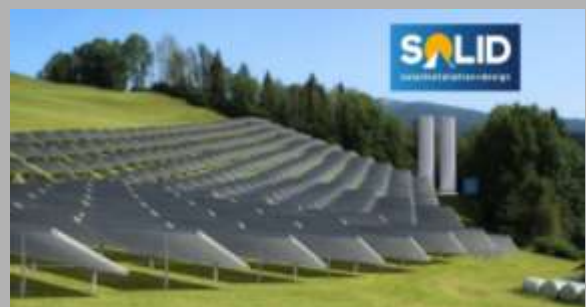
Abbildung 23: Kollektorfläche Solaranlage Mürzzuschlag (Bildquelle: SOLID)
