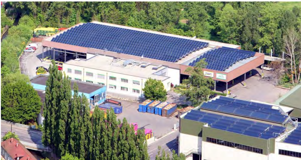
Figur 15. Solvärmeanläggning ansluten till fjärrvärmesystemet i Graz (2006).
