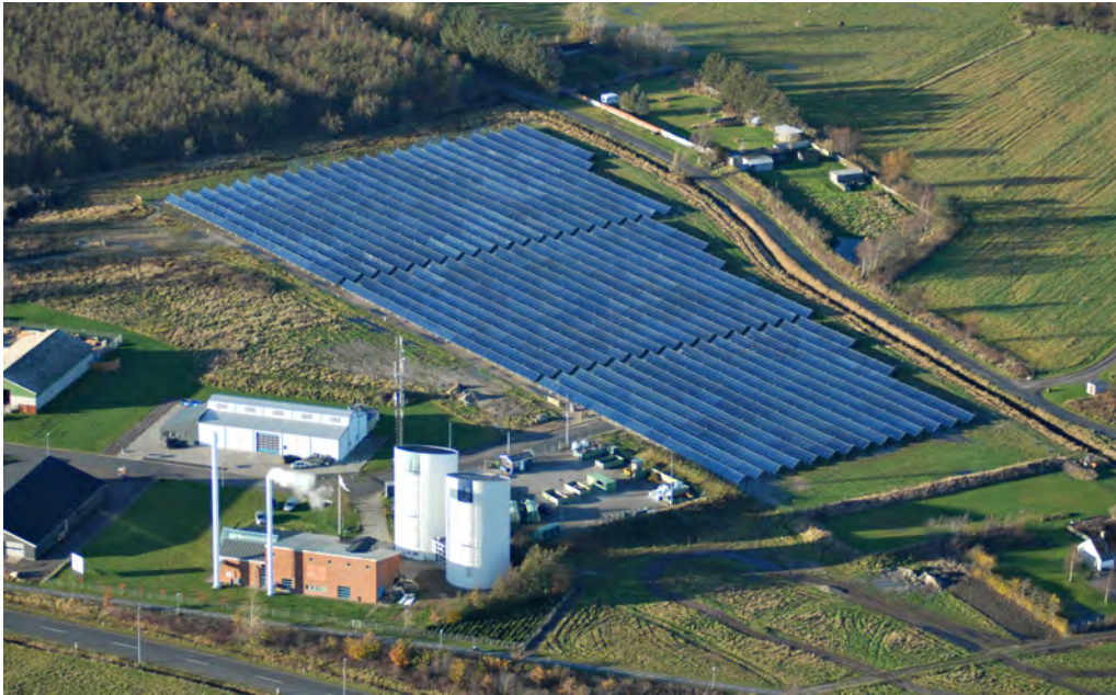
Figur 12. Solvärmeanläggning med 8 000 m 2 solfångare i Strandby (2008).
