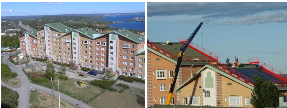
Bild 7. Solfångare monterade på höghus på Brf Örnen i Timrå.
