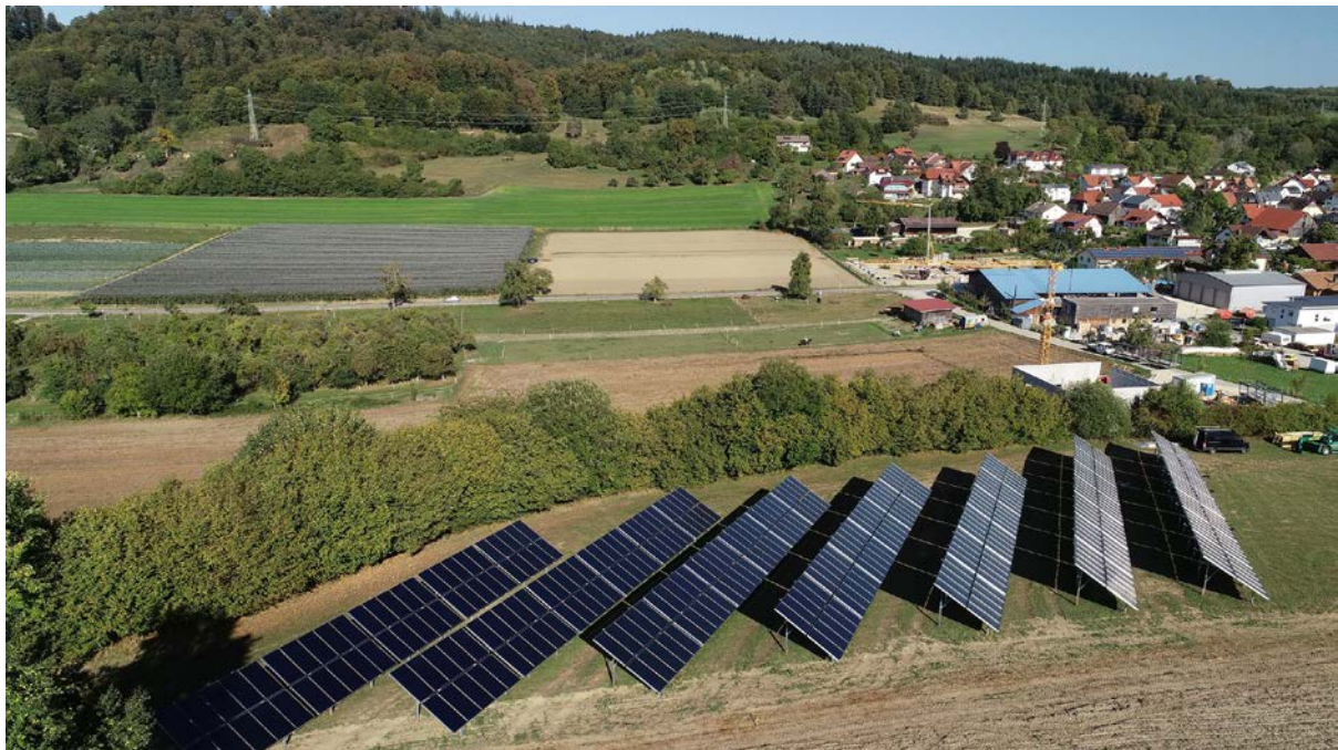
Bild 1 - Quellenhinweis „Stadtwerke Radolfzell GmbH“: In Liggeringen versteckt sich das Kollektorfeld hinter einer Baumreihe. Es liefert im Jahresverlauf 20 Prozent der Wärme und übernimmt im Sommer die Versorgung des Dorfes komplett.
